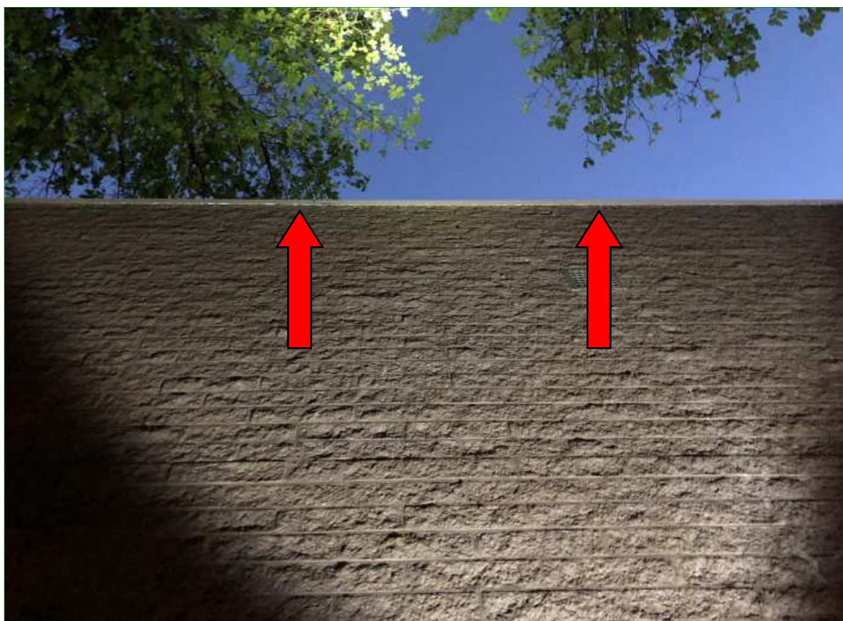
Enkele locaties (rode pijlen) aan de zuidoostkant van de bebouwing waar twee verblijvende Gewone dwergvleermuizen zijn aangetroffen. Deze vleermuizen vlogen uit vanonder de metalen dakrand, verspreid over de gevel.
