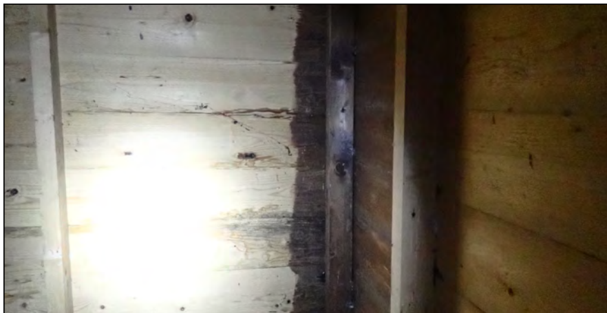
Figuur: de gebouwen zijn erg vochtig. Op veel plekken trekt er vocht in de muren en staat de vloer gedeeltelijk onder water.
