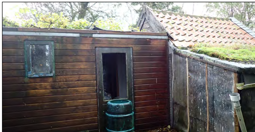
Figuur: de meeste gebouwen hebben gebroken ramen, waardoor de gebouwen erg tochtig zijn.
