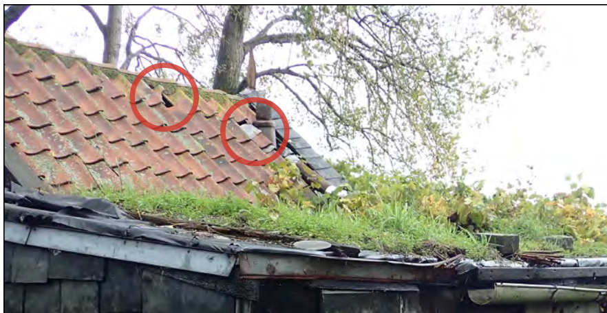
Figuur: één van de gebouwen heeft een pannendak met losse of gebroken pannen. Vleermuizen kunnen hieronder een verblijfplaats hebben.
