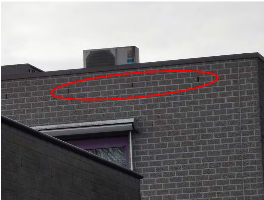
Open stootvoegen Ymere gebouw aan oostkant projectgebied
