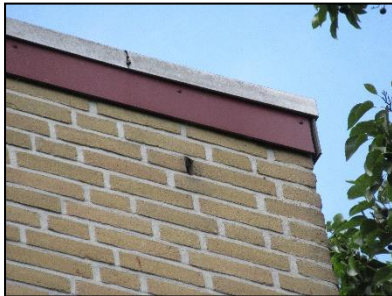
Figuur 23. Open stootvoeg met donkere vlekken eromheen. Mogelijke indicatie voor gebruik door vleermuizen. (gebouw 3).
