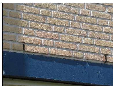
Figuur 7. Open stootvoegen in gebouw 2.
