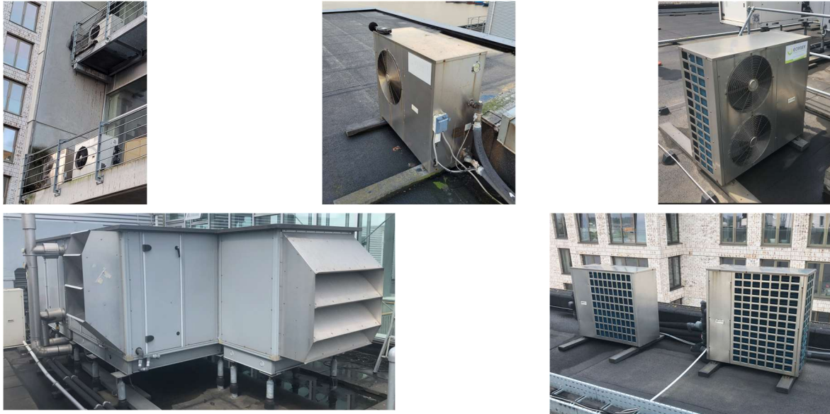
Fig. 3.3: Foto's installaties gebouw 1
