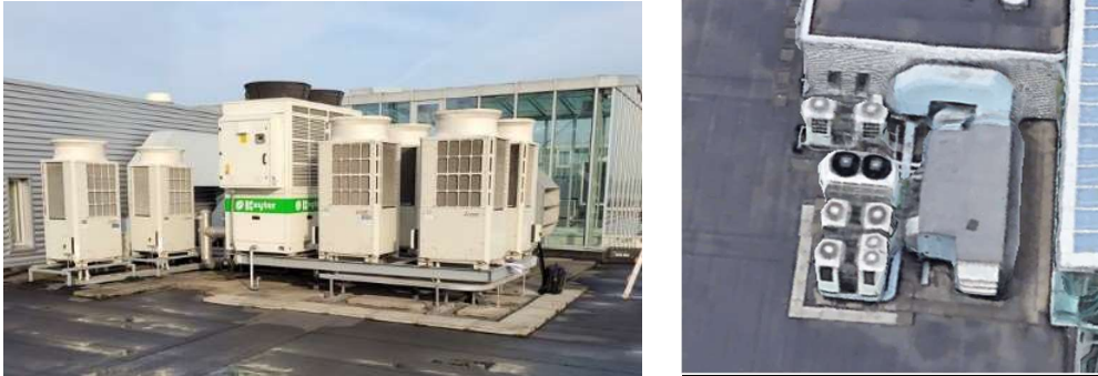
Fig. 3.4: Foto's installaties gebouw 2
