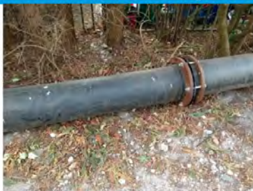
13. Puin onverhard oppervlakte aan westzijde gebouw G
