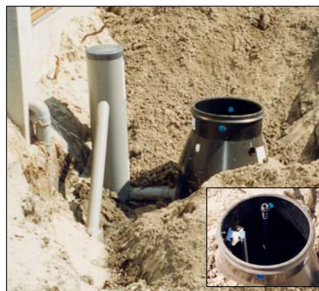
Inspectie/doorspuitput met pompput
