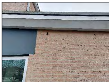
Figuur 9. Open stootvoegen in de gevel van de aanwezige bebouwing.
