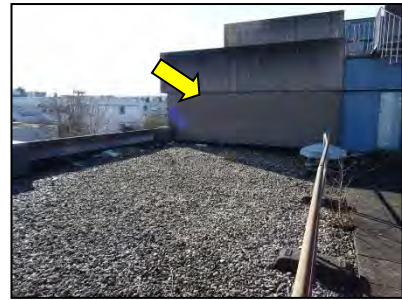
Figuur 13. Lage stootvoegen in de gevels op het platte dak.
