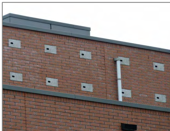
IB GZ 01 kasten ingemetseld in de gevel
