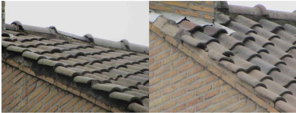
Figuur 5.3. Openingen en holten onder en tussen (gebroken) dakpannen.
