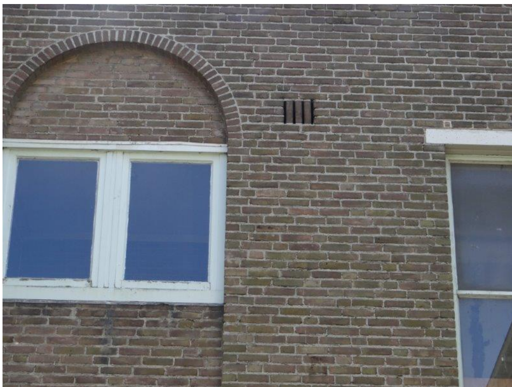
Foto 2. Onder andere spouwroosters kunnen vleermuizen toegang geven tot een verblijfplaats.
