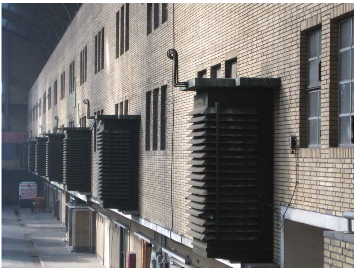
Verhitters in de Centrale Markthal, westzijde, april 2009 (BMA)
