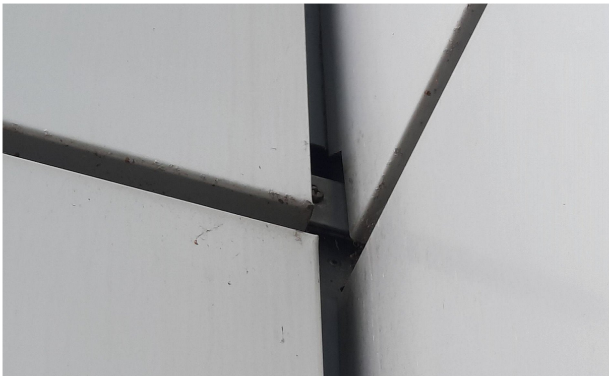
Openingen tussen metalen panelen, ongeschikt voor vleermuizen. Foto: B. Verhoeven | Ecoresult B.V.
