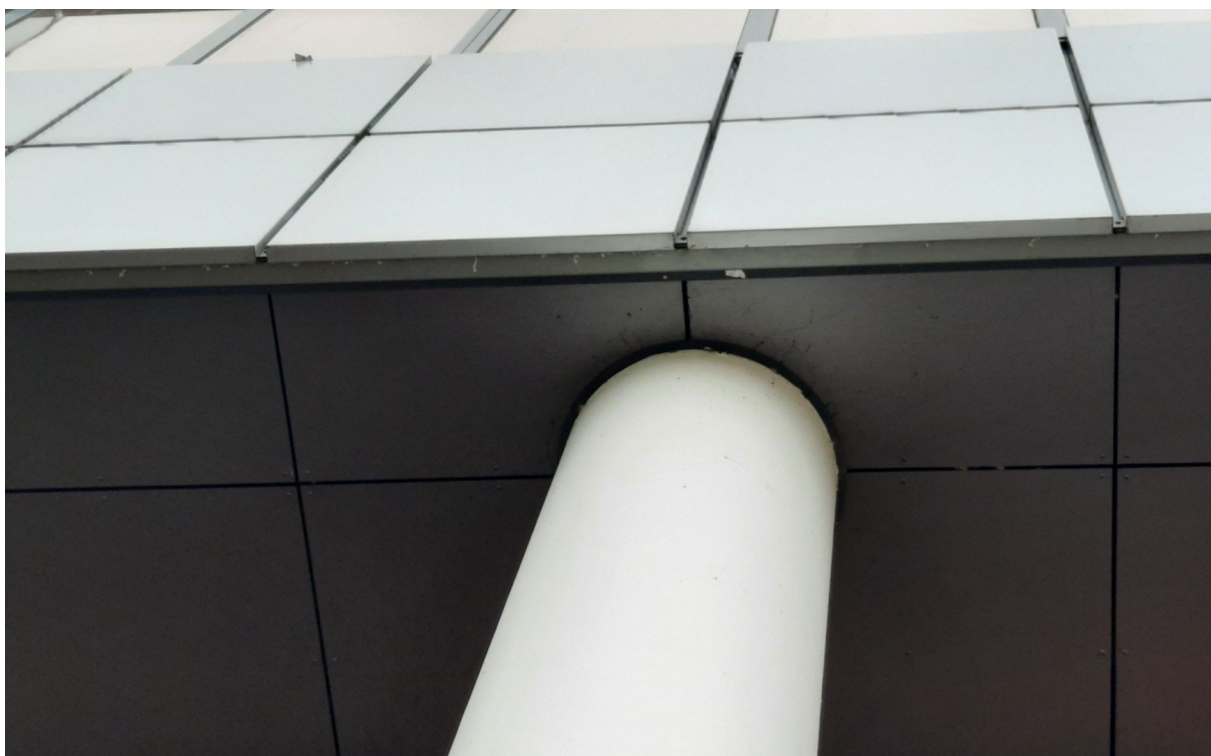
Kieren tussen trespa panelen, ongeschikt voor vleermuizen. Foto: B. Verhoeven | Ecoresult B.V.
