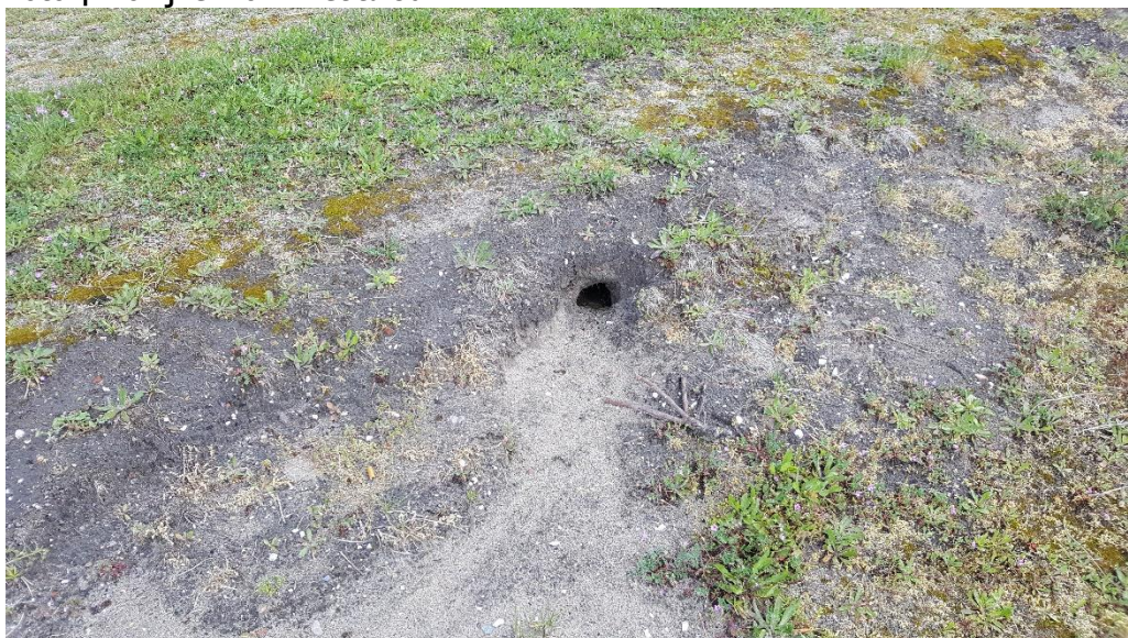
Foto 4: Konijnenhol in het talud
