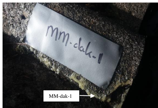
Foto 4: Asbesthoudende golfplaat als dakbedekking van schuur 1.
