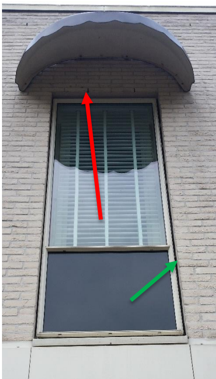
Foto 7 open stootvoegen (rood) en slecht aansluitende kozijnen (groen) waar vleermuizen naar binnen kunnen kruipen
