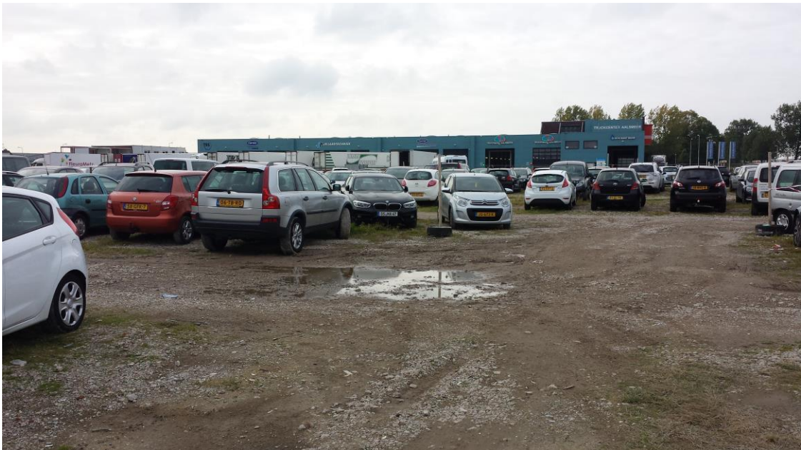
Afbeelding 4: Zelfs na de lange droge nazomer van 2016 zijn nog waterplassen aanwezig op de verdichte ondergrond.
