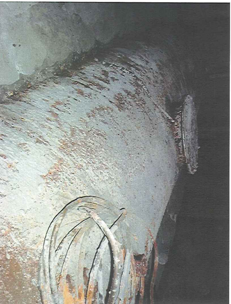
Foto 2: tankinstallatie in kelder
