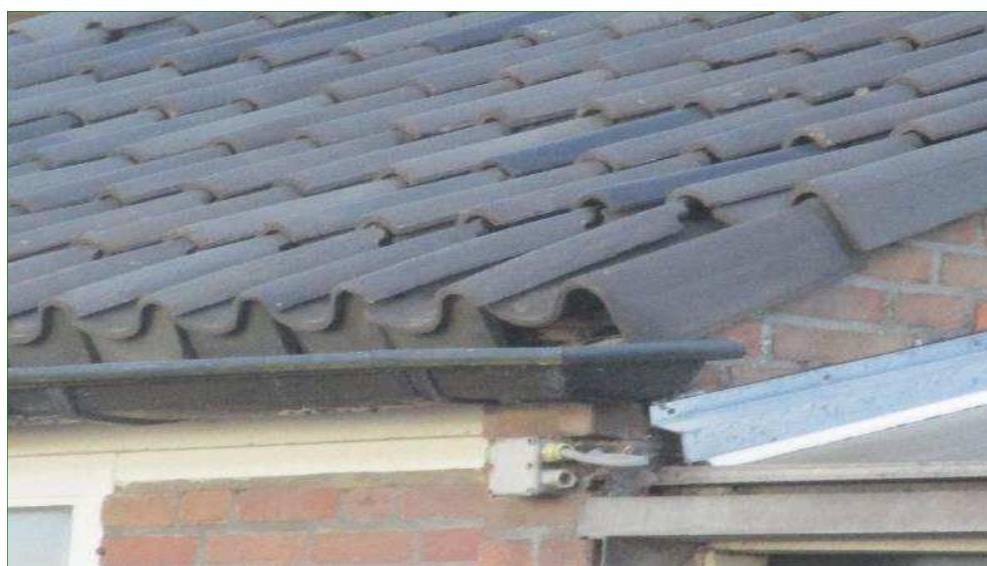
Deze dakpan bij de achtergevel van Noorddammerweg 83 is aan de onderkant open en biedt mogelijk toegang tot voor Huismussen geschikte achterliggende ruimtes.
