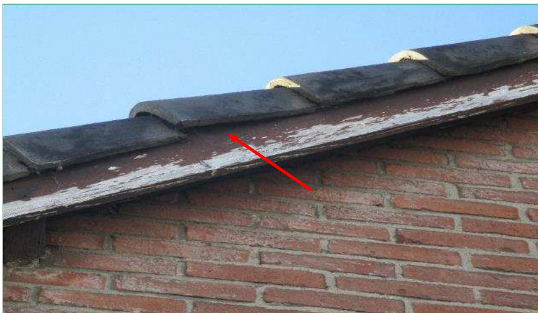
Ruimte onder dakpannen bij de bebouwing van Royant Stone Art bv. bieden mogelijk toegang tot voor vleermuizen geschikte achterliggende holtes.
