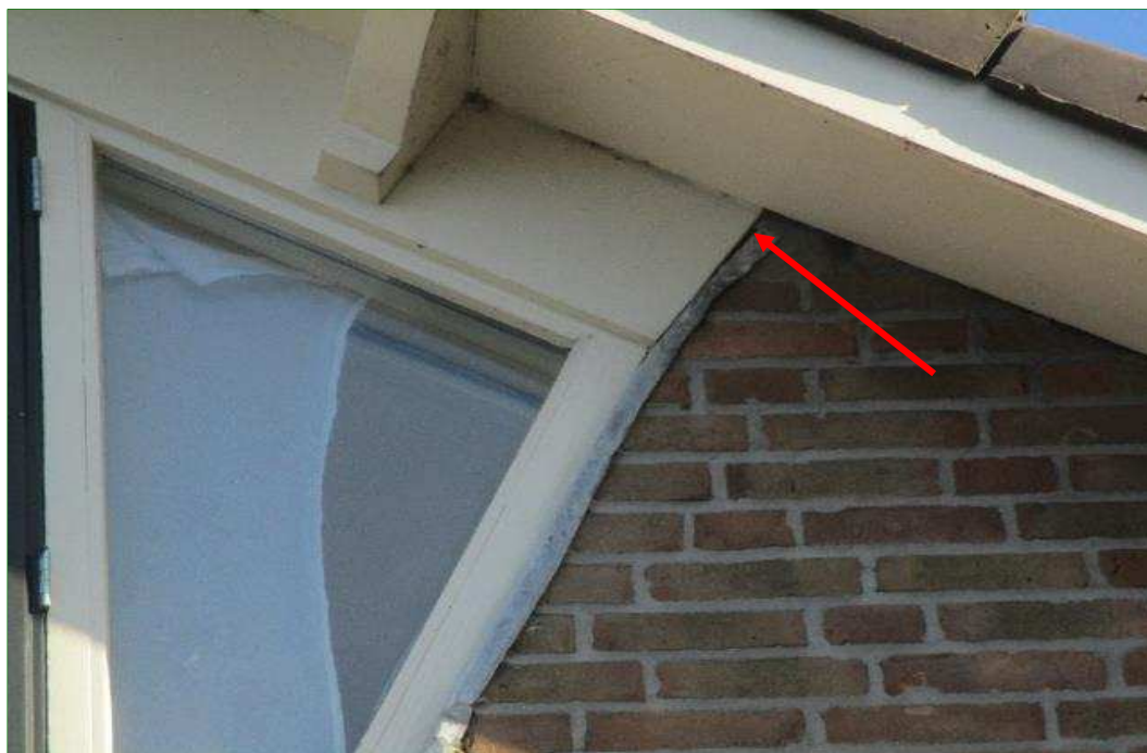
Kier tussen loodslab en houten dakrand bij de zijgevel van Noorddammerweg 83 biedt mogelijk toegang tot voor vleermuizen geschikte achterliggende holtes.
