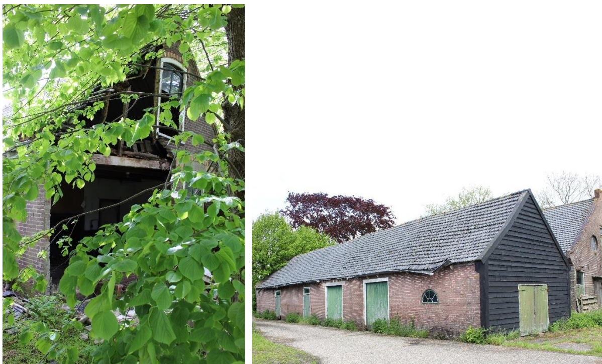
Figuur 13: Links: de deels ingestorte voorgevel van het zomerhuis. Rechts; het houten beschot dat werd aangebracht na het instorten van de achtergevel, en de linker zijgevel.
