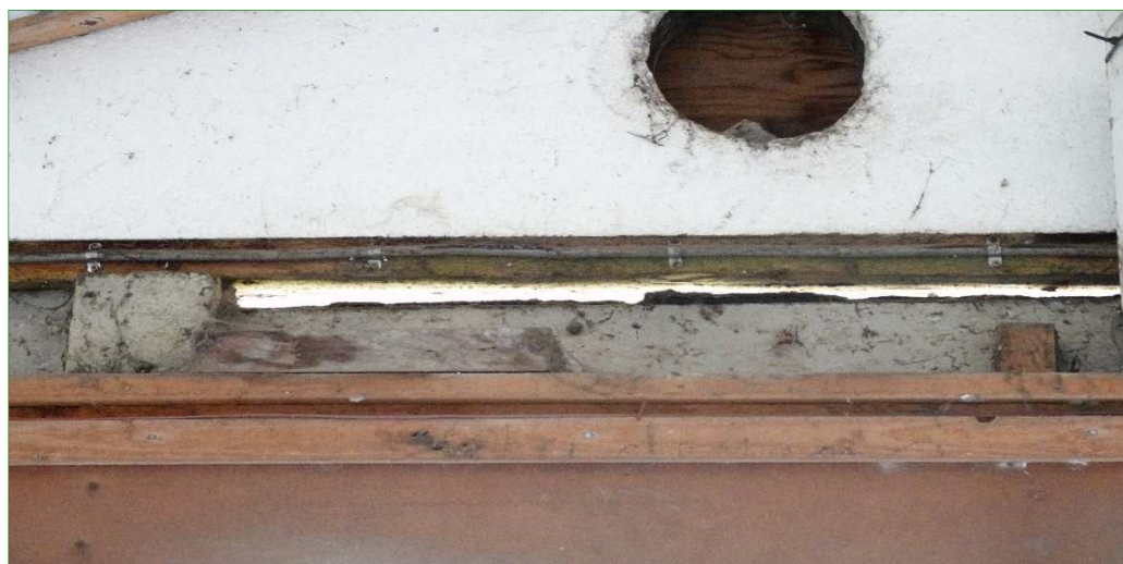
Binnenzijde van de houtbetimmering met een groot gat. Tussen de betonbeplating van de schuur en de houtbetimmering zijn kieren ontstaan die direct naar buiten lopen.
