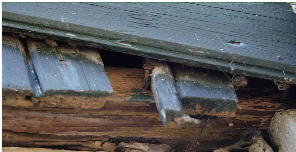
Gat in de houtbetimmering op de oostzijde.
