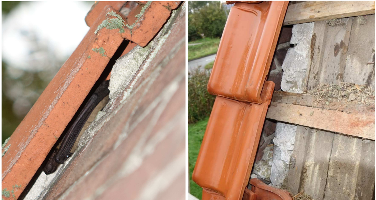
Figuur 5. Laatvlieger onder de dakrand van de woning (links) en (toegankelijke) spouw aan de voorgevel van de woning. (rechts)
