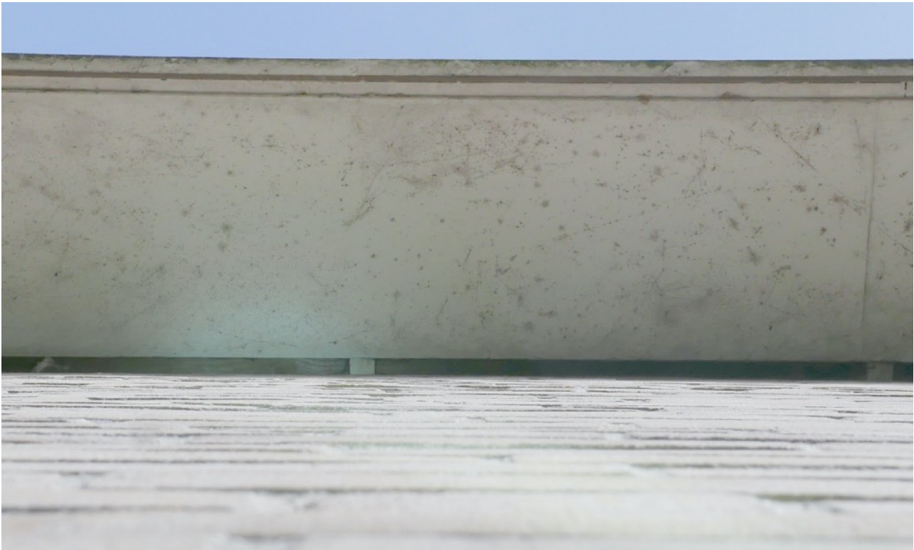
Afb.4: Detail van de rand tegen de stenen gevel. Te zien is dat deze slecht een klein stukje doorloopt en geen ruimte biedt voor verblijfplaatsen van vleermuizen.
