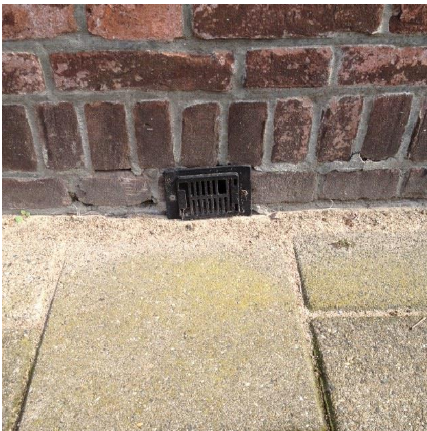
Figuur 9. Kruipruimteventilatie met roosters.
