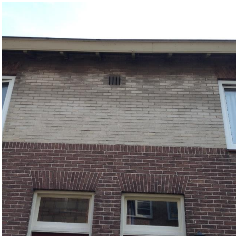
Figuur 2. Spouwmuurventilatie Eikelenbergstraat.
