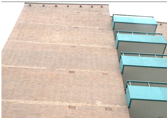
Figuur 7. Zicht op de ventilatieopeningen in de muur. De spouwmuren zijn niet geïsoleerd
