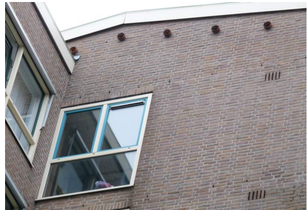
Figuur 8, Open stootvoegen boven de raampartijen.
