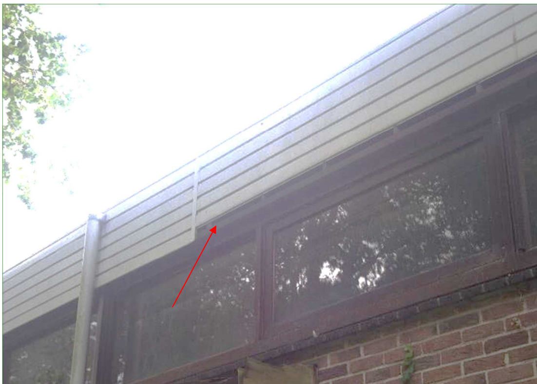
Aan de achterzijde van het pand ontbreken enkele planken van de houten dakomlijsting. Ook dergelijke gaten kunnen potentieel toegang bieden tot verblijfplaatsen van vleermuizen.
