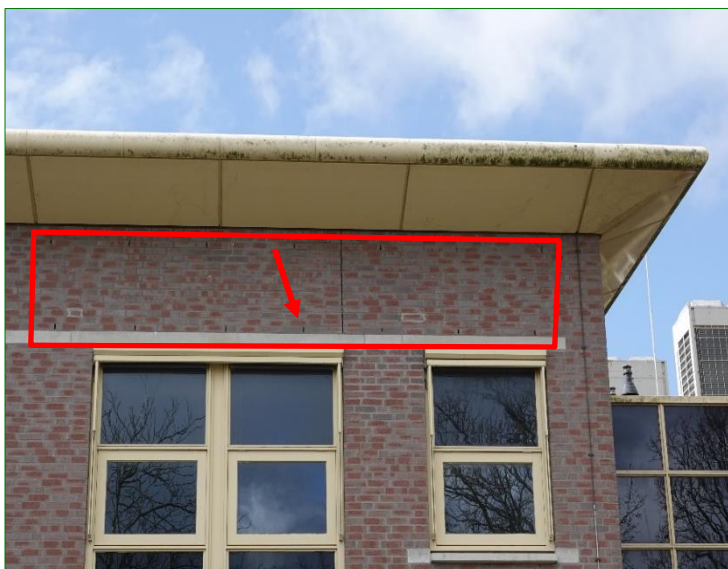
Veel open stootvoegen zijn in de muur aanwezig.
