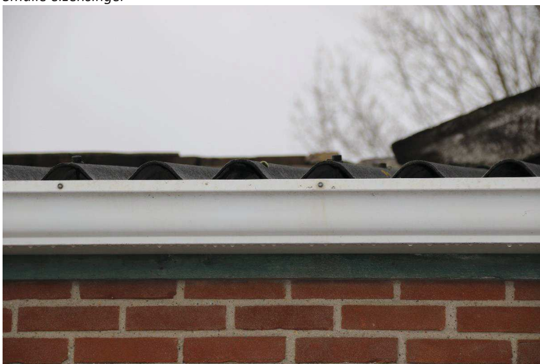
Ongeschikte dakgoot van noordelijke bijgebouw
