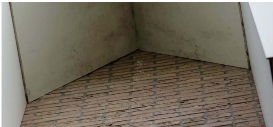
Figuur 3. Vogelsporen (uitwerpselen) in de nok van het gebouw.
