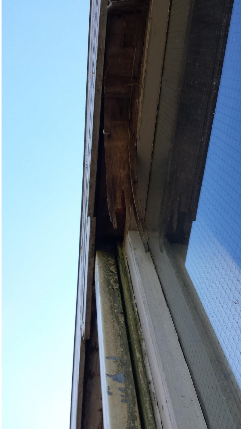
Wegrottende beplating aan het gebouw
