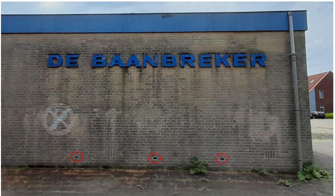
Figuur 5. Er zijn open stootvoegen aanwezig in de muren, maar deze zijn niet geschikt voor vleermuizen, aangezien deze zich vlak boven de grond bevinden.
