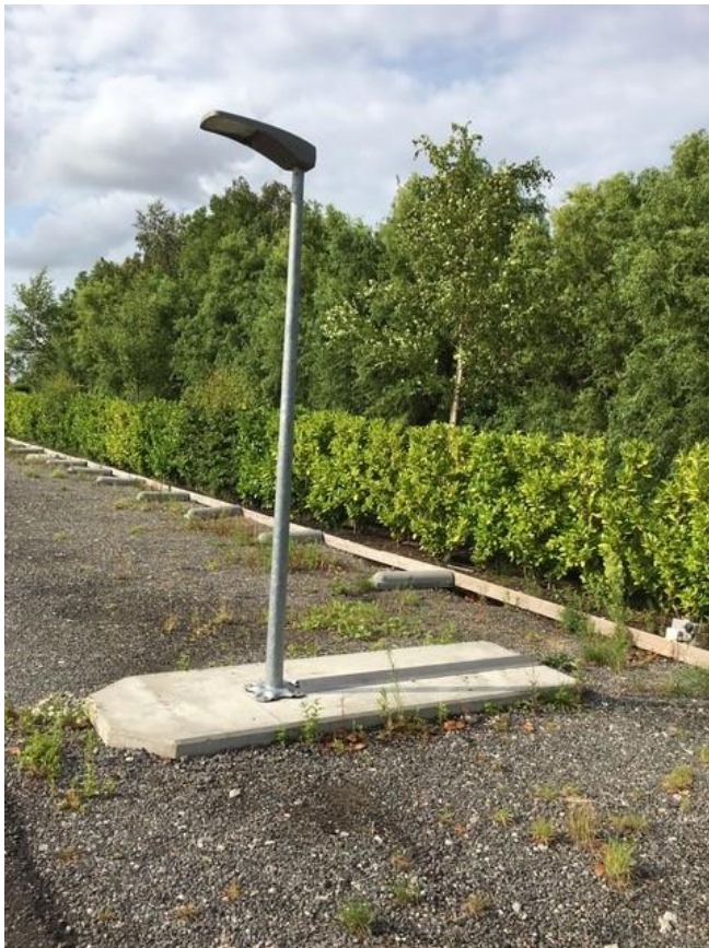
Figuur 6 Mobiële lichtmast
