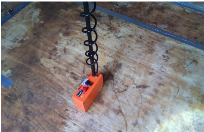
toelichting foto: pompopstelling en plek waar gesaneerd is
