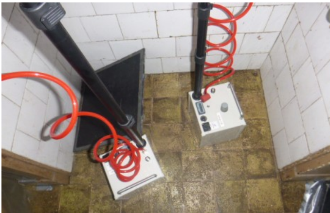
toelichting foto: afwijkende pompopstelling
