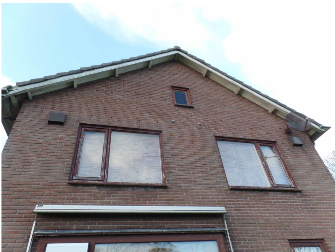
Figuur 3: De woning is aan de binnenzijde dichtgetimmerd
