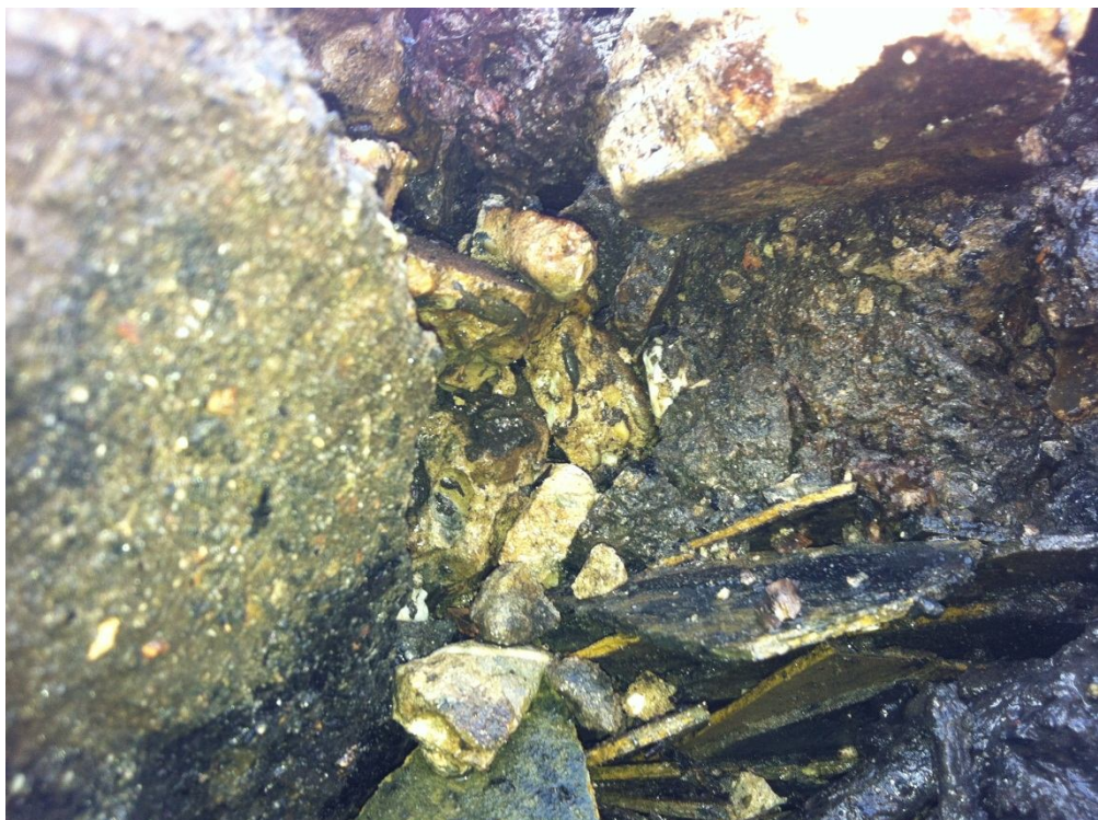
Foto 12, detail asbestverdachtmateriaal in de funderingsbak
