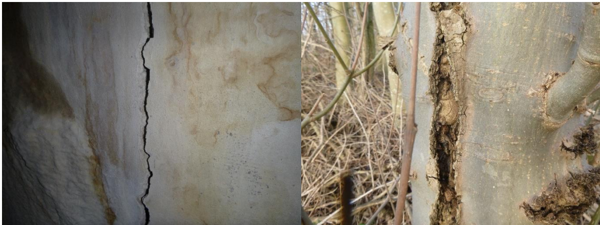
Figuur 3-2. Geschiktheid voor vleermuizen. Links een scheur in het stucwerk dat doorloopt in het beton; rechts holte in een boom op de muur.
