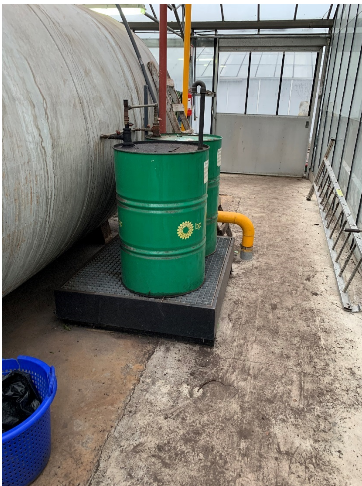
Twee olievaten in het ketelhuis
