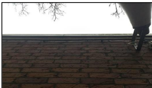
Foto 4: Aluminium dakrand met kier eronder
