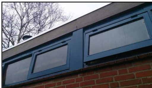
Foto 8: Kieren onder kozijnrand en aluminium dakrand
