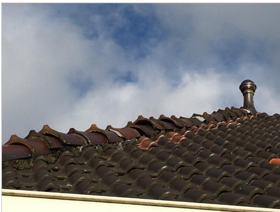
figuur 4.4: losliggende dakpannen welke mogelijk ruimtes bevatten waar gierzwaluwen in kunnen broeden.
