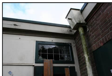
Foto 16: Spleten onder de dakranden
