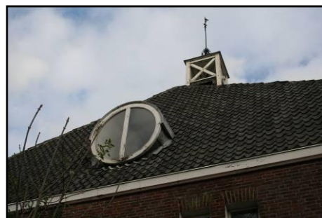
Foto 12: Kieren tussen loodflappen en dakpannen
