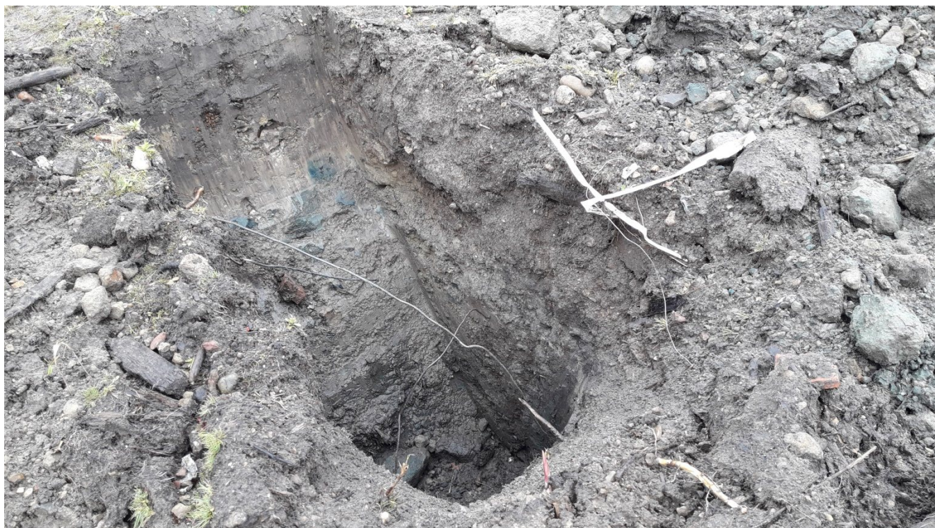
Foto 1: overzicht inspectiegat (met zichtbare bijmengingen)
