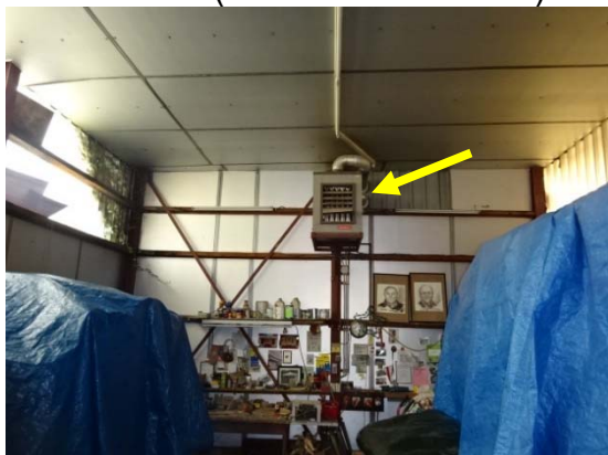
Foto 5: Luchtverhitter "UNIVERSUM" in Loods 1 (niet asbesthoudend)
