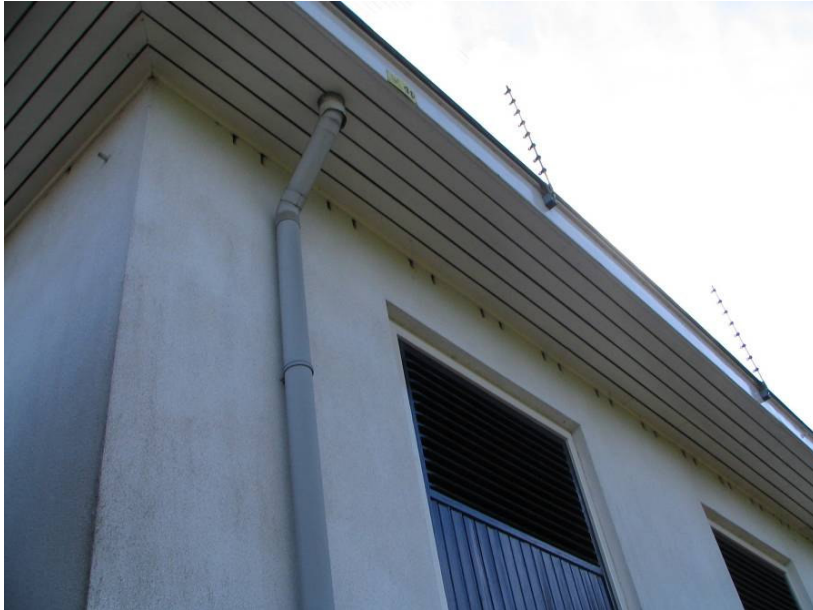
Afbeelding 5.2: stootvoegen in het drinkwaterfiltergebouw. Door de hoeveelheid geluid is dit gebouw ongeschikt voor vleermuizen.
