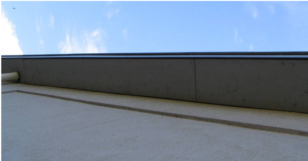
Afbeelding 5.1: voor vleermuizen ongeschikte openingen in het gebouw rond de watertoren
