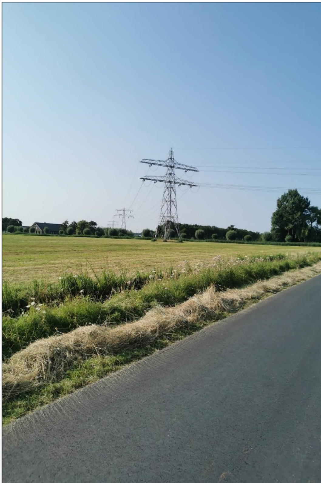
Mast 17 in een weiland aan de Ringskade.
