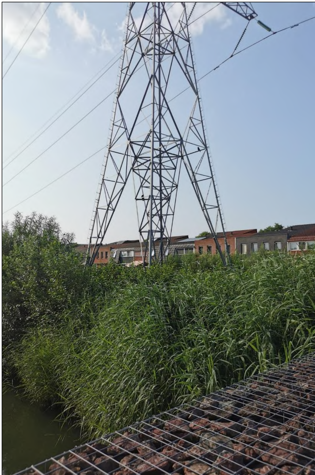
Mast 24 aan de Middelhoeve.
