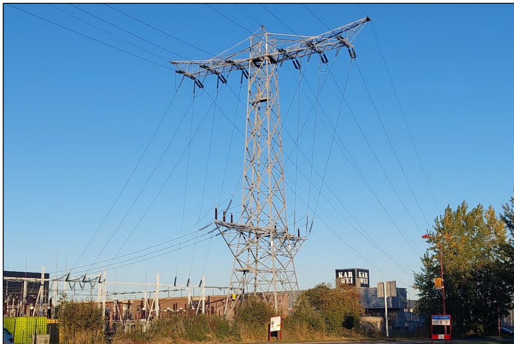
Mast 30 bij het hoogspanningsstation Nieuwegein.
