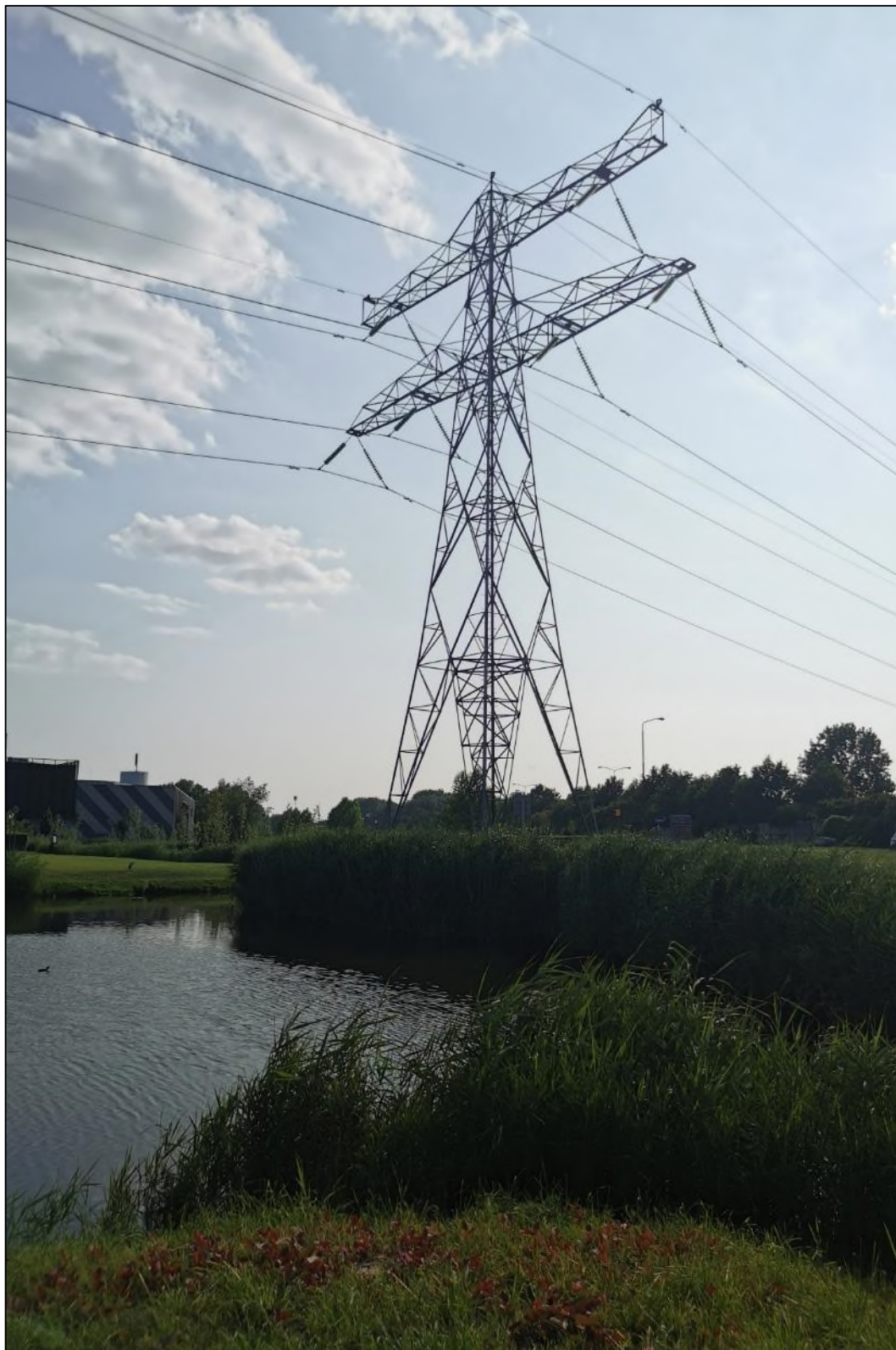
Mast 23 aan de A.C. Verhoefweg.
