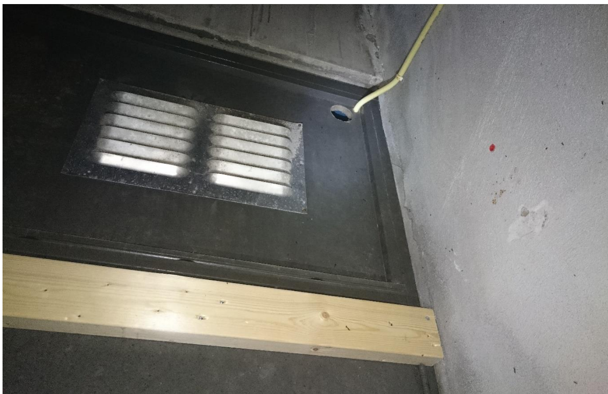
Foto 9. Aan het einde van de gang zit een deur. Boven de deur is een gat aanwezig, dat mogelijk gebruikt kan worden door vleermuizen om in het pand te komen.
