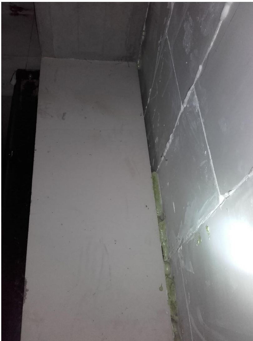
Foto 11. In het souterrain zijn ook enkele spleten tussen het betonwerk en doorgangen, zoals hier op de foto. Deze zijn allen goed inspecteerbaar (lopen niet diep door, geen obstakels in de spleten) en ze zijn ook allemaal geïnspecteerd op vleermuizen. Er zijn geen vleermuizen aangetroffen..
