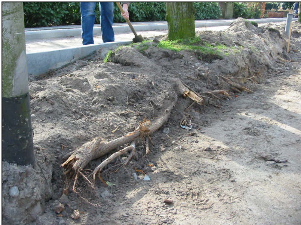
Wortelverlies en wortelschade: een dergelijke boom kan in de toekomst niet meer goed functioneren en is in zijn huidige staat waarschijnlijk niet meer stabiel.
