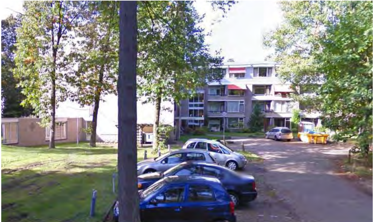
Figuur 5-2. Te behouden gebouw In de Dennen met spouwmuur en open stootvoegen (bron foto: Google Streetview).
