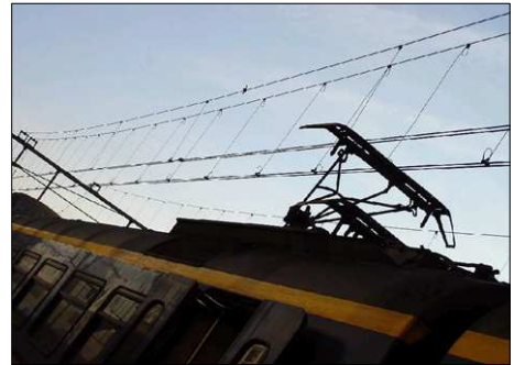
Figuur: Slijtende bovenleiding en pantograaf.
